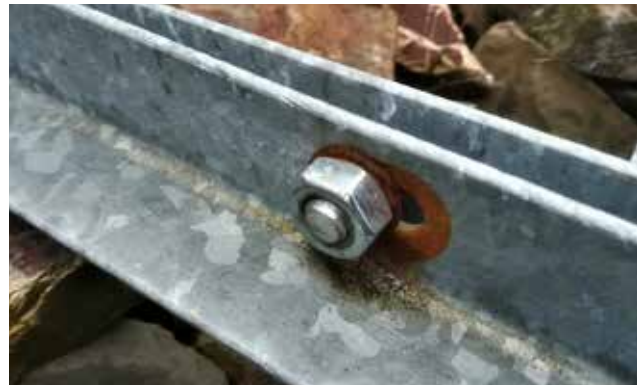
Durch eine verzinkte Unterlegscheibe und eine Edelstahlmutter ist ein ungünstiges Flächenverhältnis entstanden (Quelle: OBO Bettermann)
