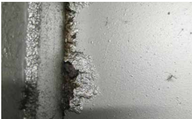
Spaltkorrosion an einer Einhausung. Durch die fortschreitende Unterrostung wird die Beschichtung beschädigt (Quelle: OBO Bettermann)
